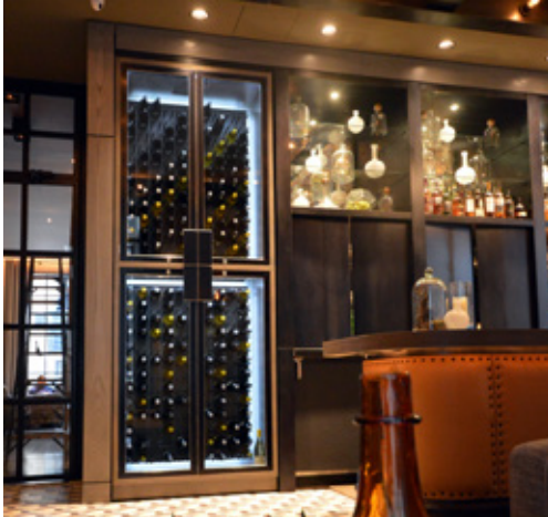
Armoire à vin climatisée par le système Wine Guardian. Photo avec l'aimable autorisation de : Genuwine Cellars
