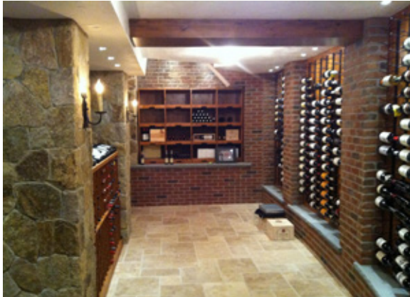
Instalación Split Wine Guardian. Cortesía: Bodegas de Vinos A La Medida
